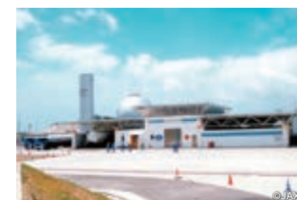
高圧ガス貯蔵供給所
