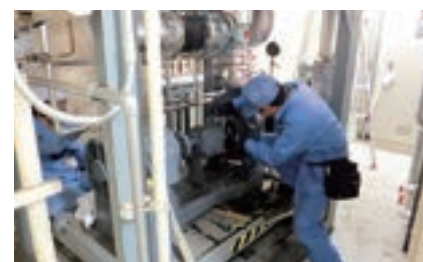
空調点検作業（筑波宇宙センター）
