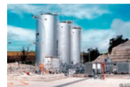
液化酸素貯蔵供給所
