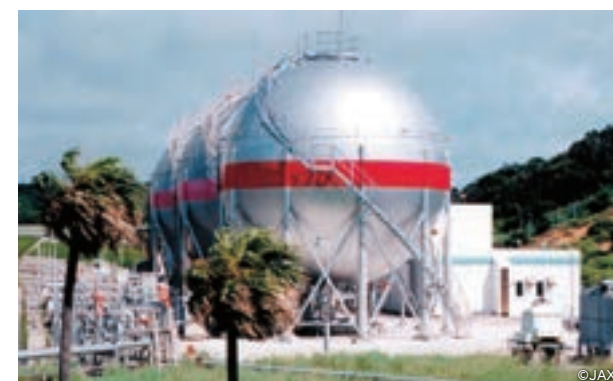
液化水素貯蔵供給所
