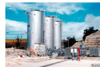
液化酸素貯蔵供給所
