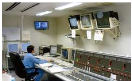
大崎発電所電力監視設備（種子島宇宙センター）
