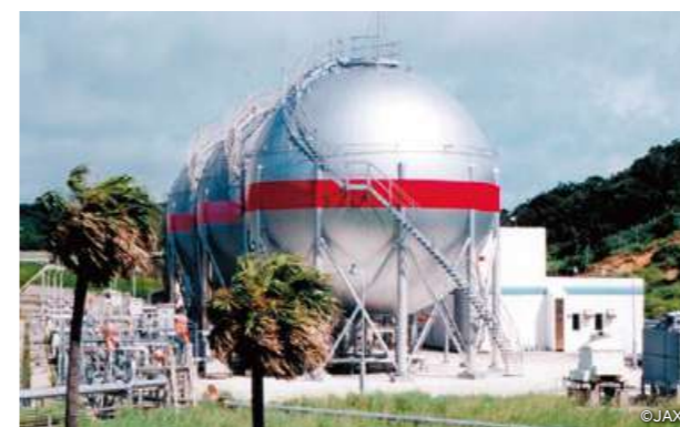
液化水素貯蔵供給所
