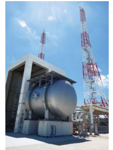
種子島宇宙センター冷却水設備の更新
