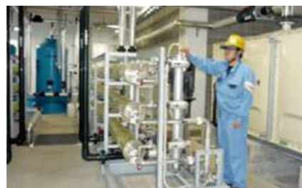
大崎浄水場膜ろ過装置運用（種子島宇宙センター）
