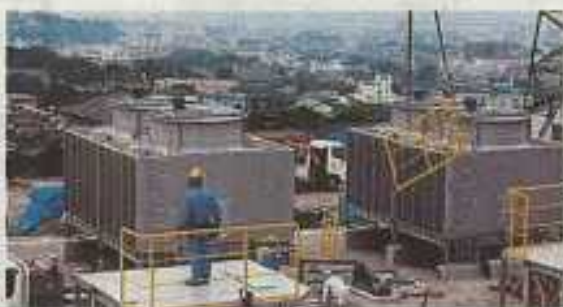
温泉地を望む高台で整備が進むコスモテックの温泉発電所。大分県別府市
